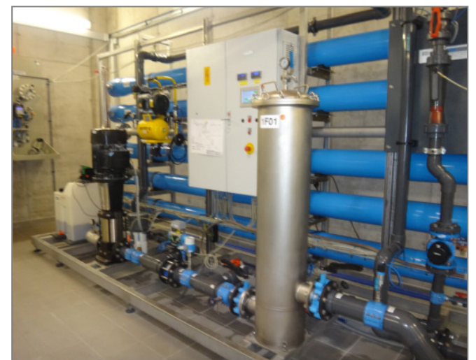
Blick in das Wasserwerk Greussen
